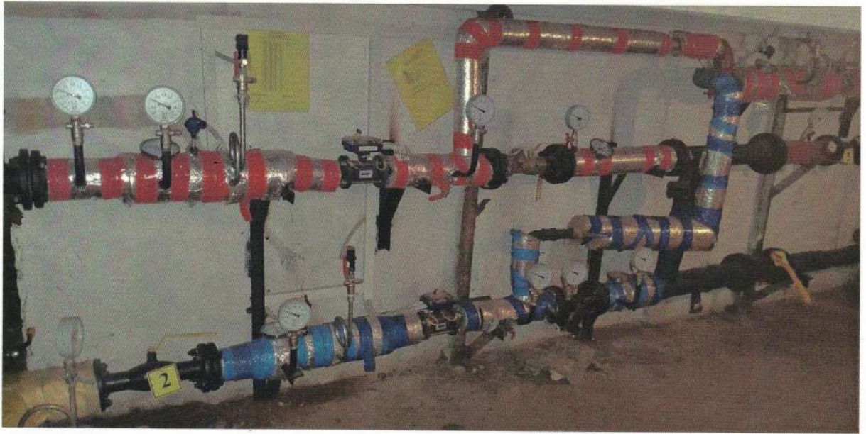
Рисунок 2. ИТП с элеваторным узлом отопления
